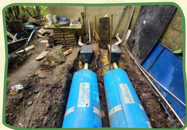
Biossistema para tratamento de esgoto instalado no espaço da ACUCA, no Quilombo do Camorim
